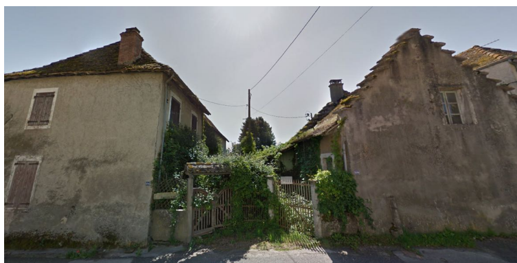
Bâtiment vétuste et vacant à Thuile
